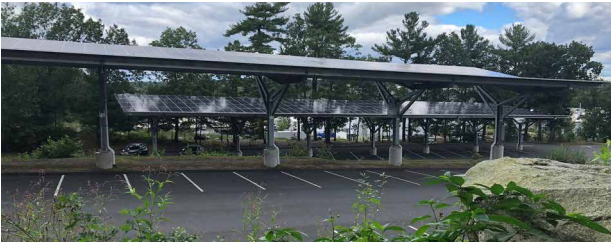
アジレントのマサチューセッツ州レキシントンサイトのカーポートソーラーシステム
